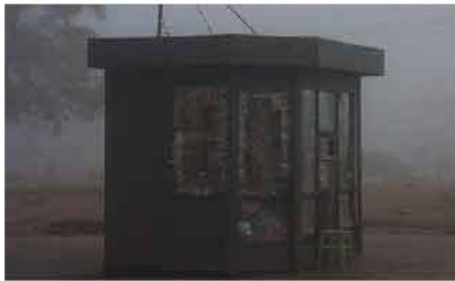
отсутствие средств наружного освещения
